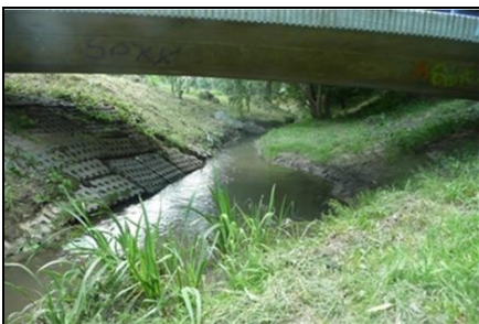
Abb. 1: zerstörte Ufer- und Sohlbefestigung nach HW-Ereignis Juni 2012, 09.10.2018
